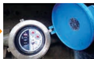
写真② 水道メーター
