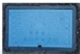
写真① メーターボックス
