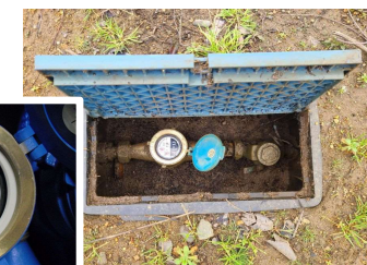
水道料金メーター
