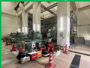
ポンプ原動機・減速機
