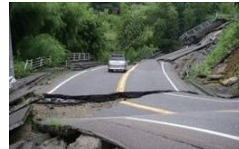
新潟県中越沖地震(長岡市大積 国道8号) 出典:「平成19年7月16日 新潟県中越沖地震」北陸地整 北陸技術事務所
