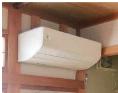
▲宮沢区(栃尾地域)のエアコン
