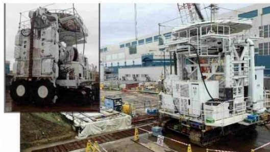
置換工法（地中連続壁工法） 地中を掘削機で箱状に掘り抜き、その後改良材を投入して、改良体を造成する
