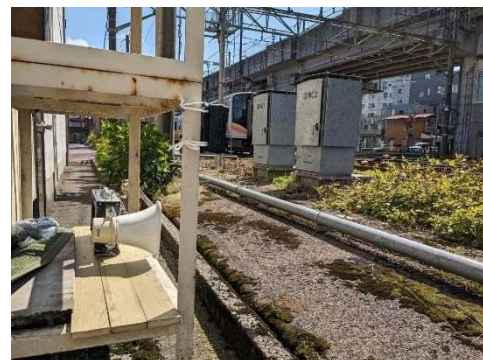
忌避音再生機器による追い払い
