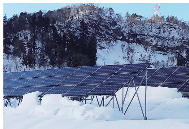
寒冷地における太陽光パネル設置の工夫（栃尾地域）
