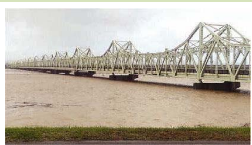
長生橋の直下まで迫る濁流 （令和元年10月）
