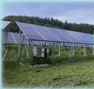
太陽光発電設備の導入
