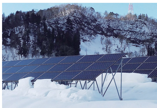
寒冷地における太陽光パネル設置の工夫 (栃尾地域)
