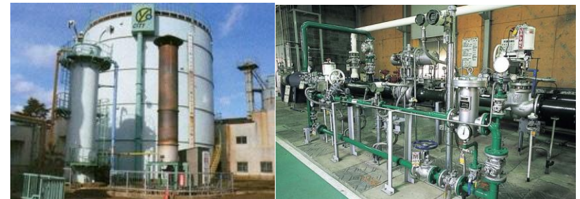
長岡中央浄化センター様 ガスタンク
