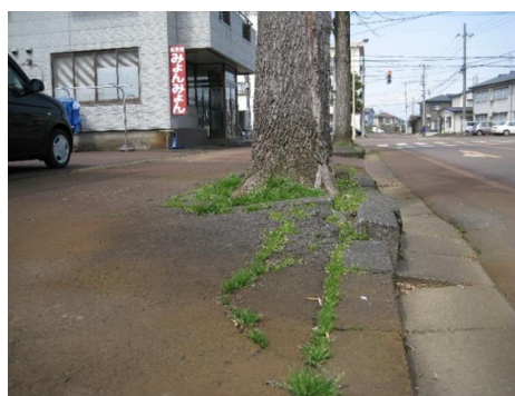
図 2-3-3-8 《巨木化による道路の破損》
