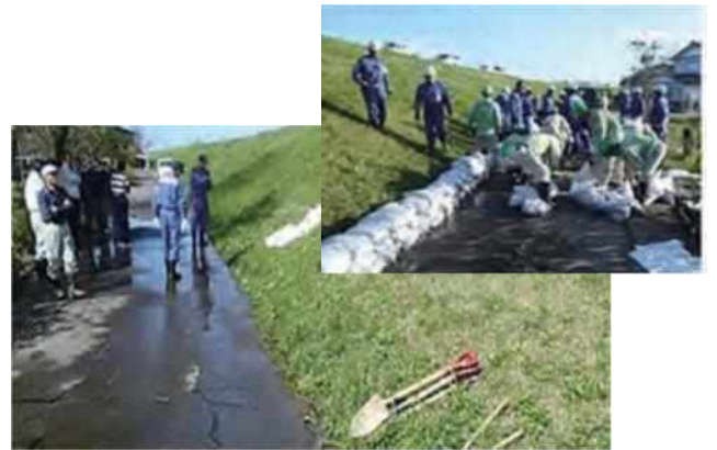
令和元年台風第 19 号による堤防の漏水(長岡地域)
