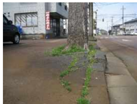
図2-3-3-8 《巨木化による道路の破損》
