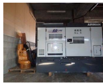
可搬式ポンプ・発電機の常備
