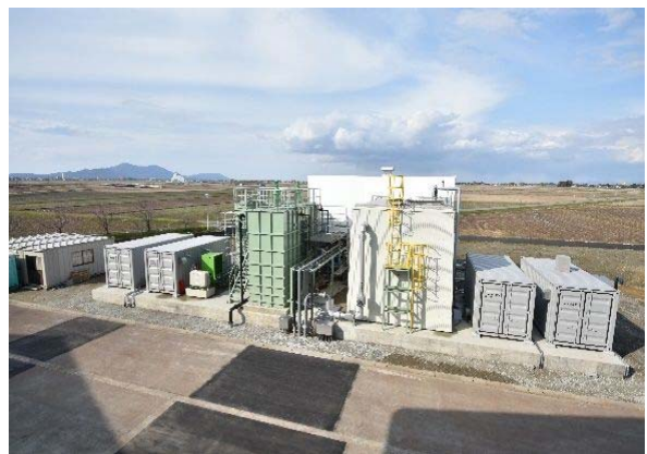
中之島浄化センター 実証研究施設
