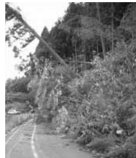
日野浦から高畑へ抜ける道路での斜面崩壊（日野浦10号線）
