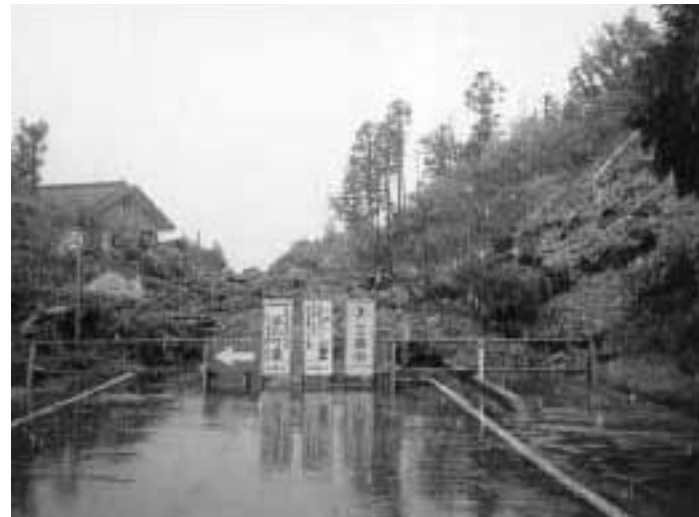
東保内道路での斜面崩壊（小島谷辺張線）
