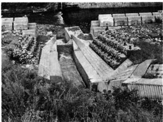
欠壊した虎谷排水路
