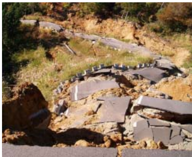
中越大震災で道路が崩落した林道 道院線。雪解けを待って復旧工事 に取りかかります
