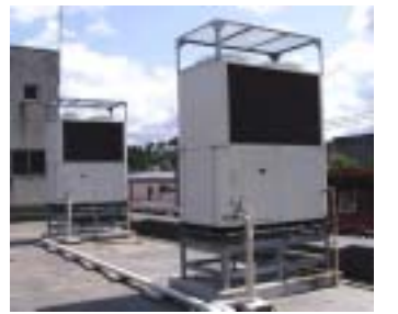
屋上に設置された空調室外機。コンパクトなのでスペースを有効利用できます
