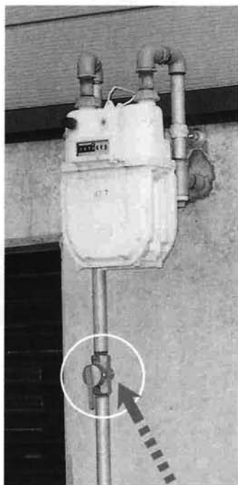
メーターガス栓
