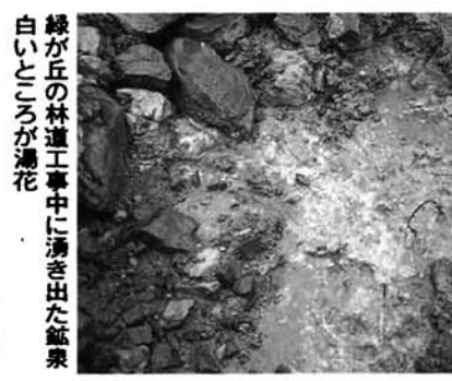
緑が丘の林道工事中に湧き出た鉱泉 白いところが湯花
