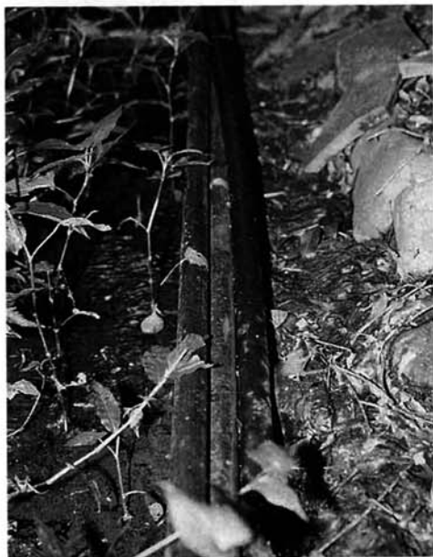
大野原の側溝をほう飲料水用パイプ。最近地区の道路改良で地下に埋められ、目に見えなくなっている。かつては、無数のパイプが側溝の中をうごめいていた。
