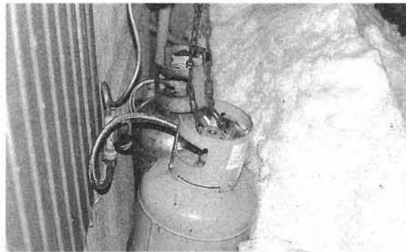
このようにガス容器が雪におされていると非常に危険です
