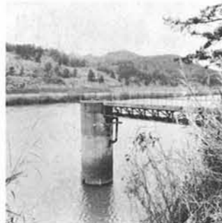
根本的な検討が望まれる取水塔
