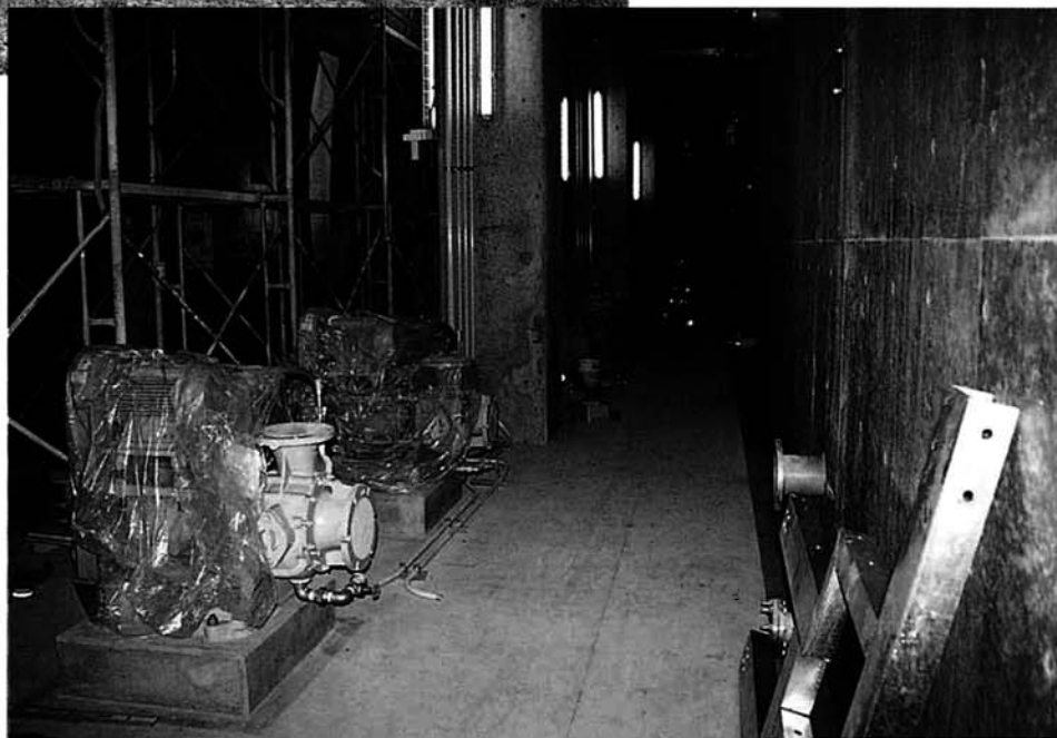
管理汚泥棟地下2階→配管室
