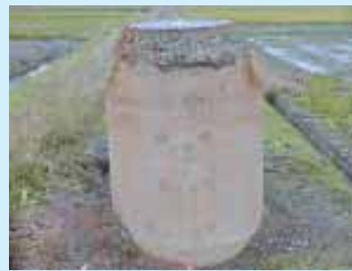
マンホールが浮き上がった下水道
