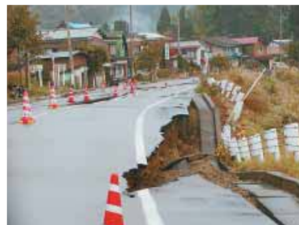
大きく欠落した県道（下村地内）
