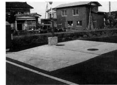
消防費 防火水槽
