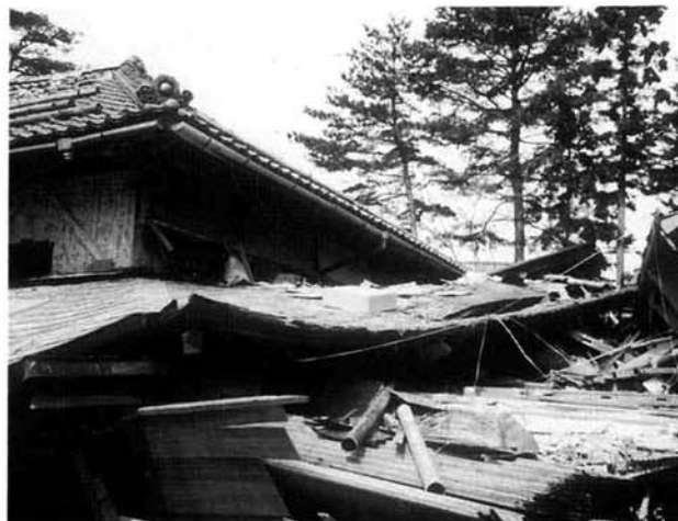
県北部の地震で被害を受けた県指定文化財「市島家住宅」
