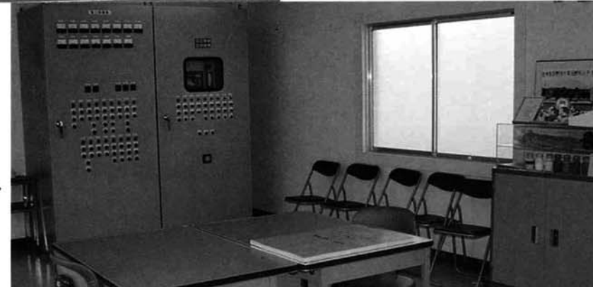
処理場の各機器類の▶ 運転監視を行う管理棟内部
