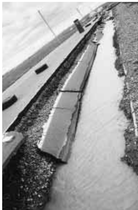
路肩が崩れた町道中西・中条線
