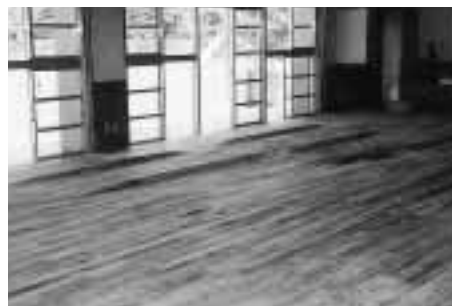
床がめくれ上がった中之島保育所
