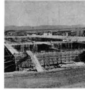
蕨王・坂之上処理区区域内の 第一下水処理場の拡張工事
