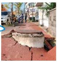
▲中越大地震の際、液状化現象で突き出たマンホール
