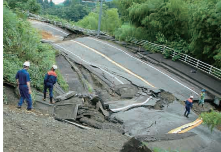
▲7月16日 中越沖地震、大積千本町の国道崩落現場
