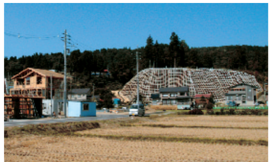
▲崩落した斜面を覆うコンクリート。写真左の集団移転団地では、住宅の建設がピークを迎えています (平成18年9月)
