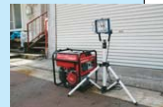
▲配備された発電機と投光器
