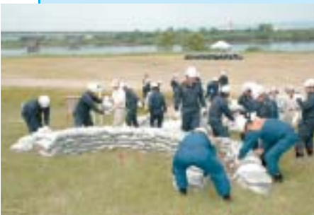
▲土のうを積んで水を溜め、その水圧で堤防からの漏水を抑える「月の輪工」「シート張工」との訓練で
