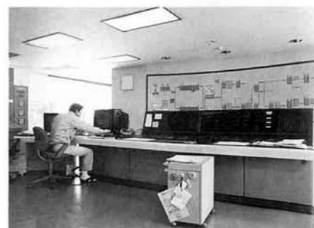
▶ 浄水場や市内の水道施設のデータを集中監視している中央管理室
