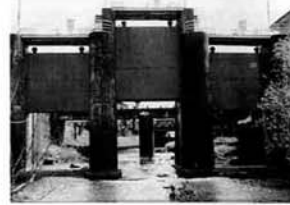
▲柿川水門。信濃川の水位が上がると、この水門が閉じられ、ポンプ排水に切り替わる
