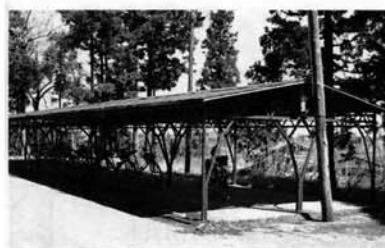
老朽化した中学校自転車小屋
