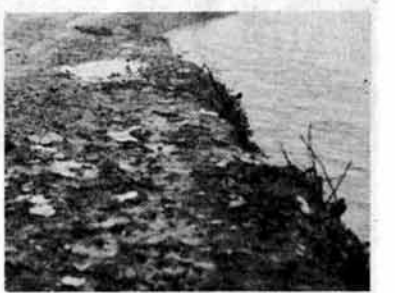
決壊が進む堤防(7月13日)
