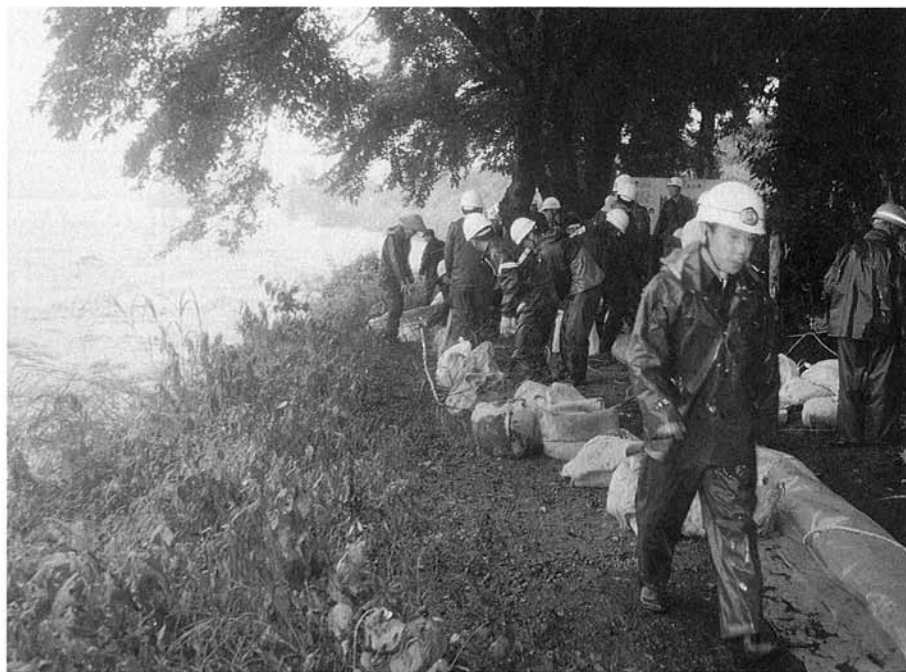
今年7月11日、梅雨前線豪雨により渋海川左岸の岩塚小学校の校庭が大きく決壊し危険な状態となる。
