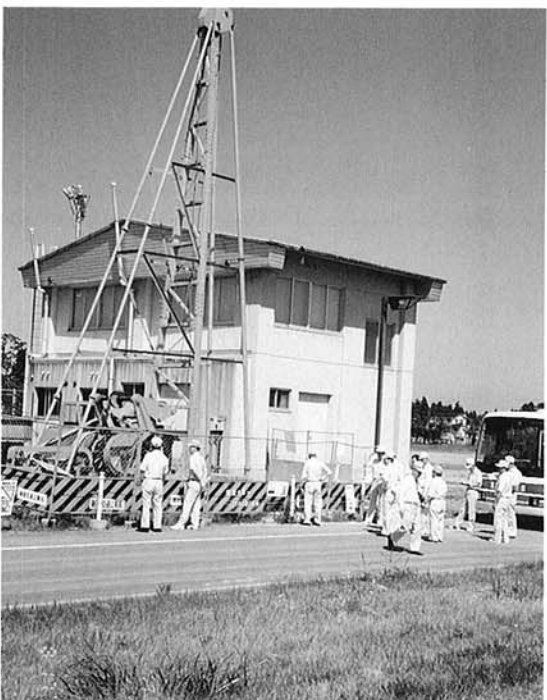
越路水道水源井（第5号）浦河川公園
