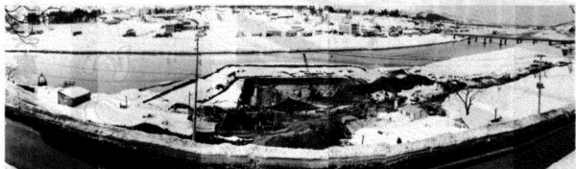
当町は地下水に恵まれないため、河川の伏流水を取水する「集水埋きよ」方式を採用した。
