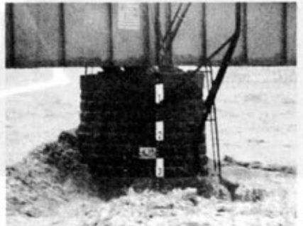
▲ 飯山線、川口鉄橋 (橋台) 昭53・6・26災害と同様の水位となる
