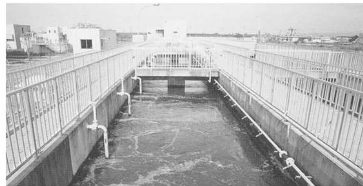
▲浄化センター水処理施設
